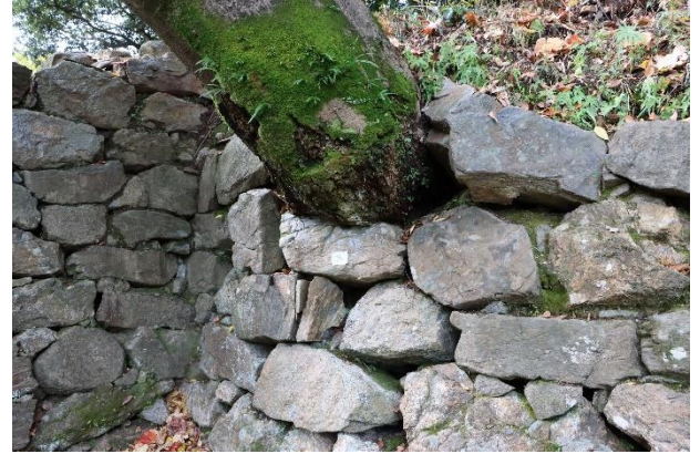
樹木の成長による石垣の損傷（本丸西）
