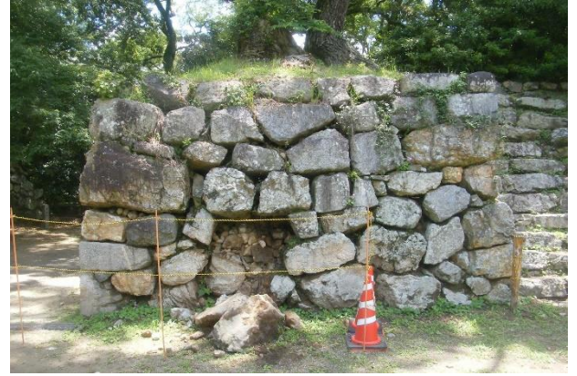
裏門石垣の部分崩落（令和元年度）
